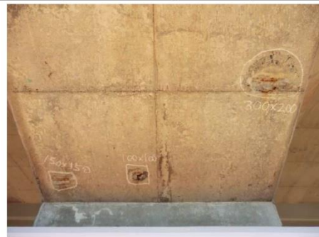
図5-8 現場検証で使用された点検調書と損傷写真のサンプル 蒲原高架橋第85橋脚梁下面(Pb0102)の剥離・鉄筋露出・漏水遊離石灰
