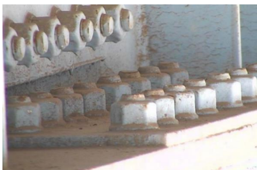
対象に正対しておらず、損傷の評価が困難 【腐食又は防食機能の劣化】
