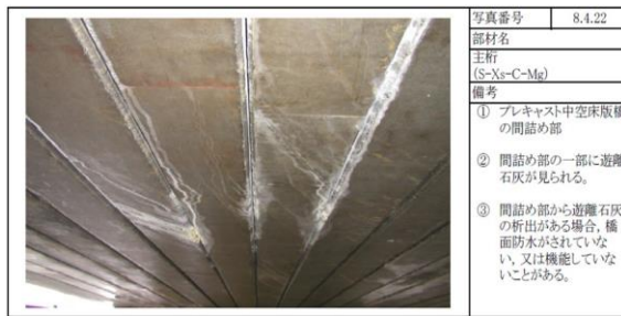
床板(漏水・遊離石灰)
