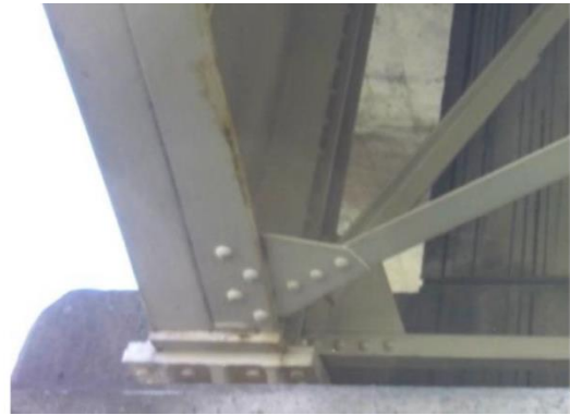
ピントが甘く、損傷の種類・損傷程度の評価が困難 【腐食又は防食機能の劣化】
