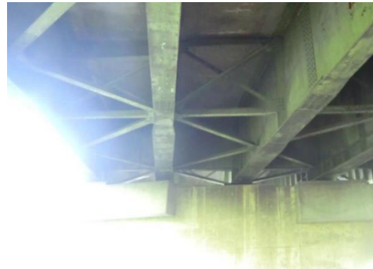
逆光で、損傷の有無の評価が困難 【腐食又は防食機能の劣化】
