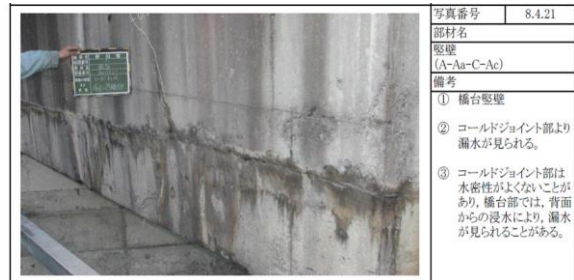
橋脚(漏水・遊離石灰)
