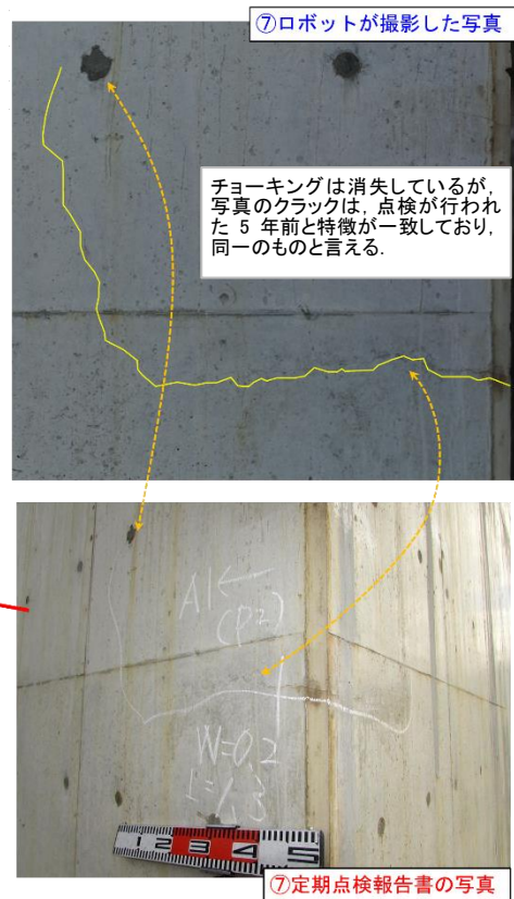
写真6-3 定期点検報告書に添付されたひび割れ⑦の写真
