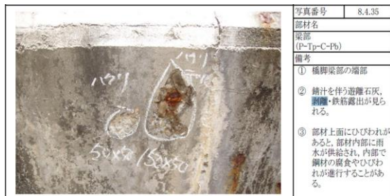
剥離・錆汁・鉄筋露出
