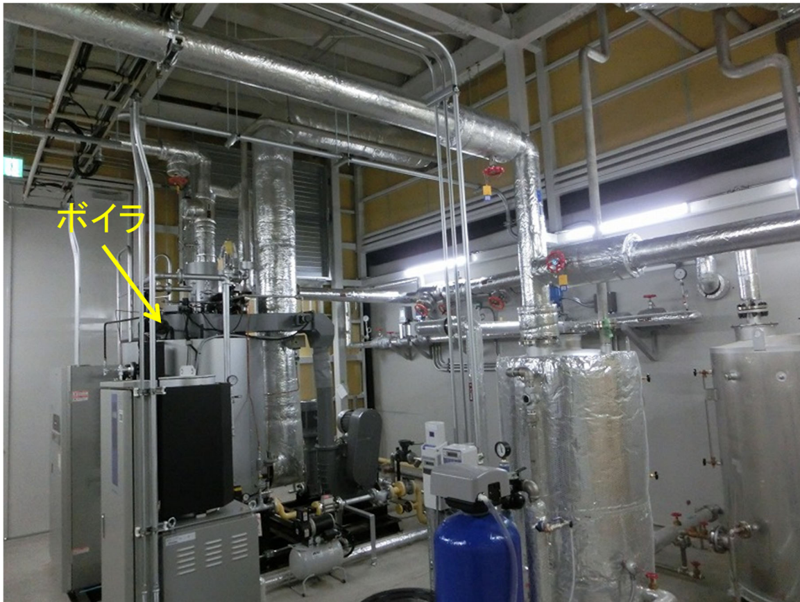
図 3-2 汎用蒸気試験設備（拡張）ボイラ周りの外観写真
