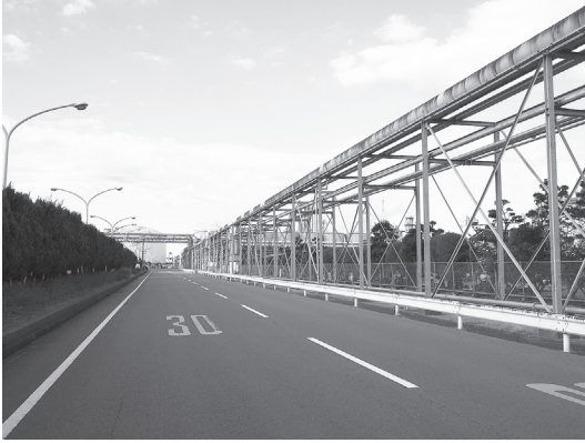
写真1 鹿島共同施設が管理するパイプライン架台および緑地帯
