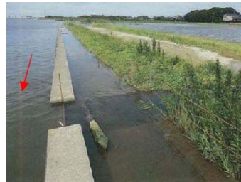
図-8 矢板の被災事例(利根川)
