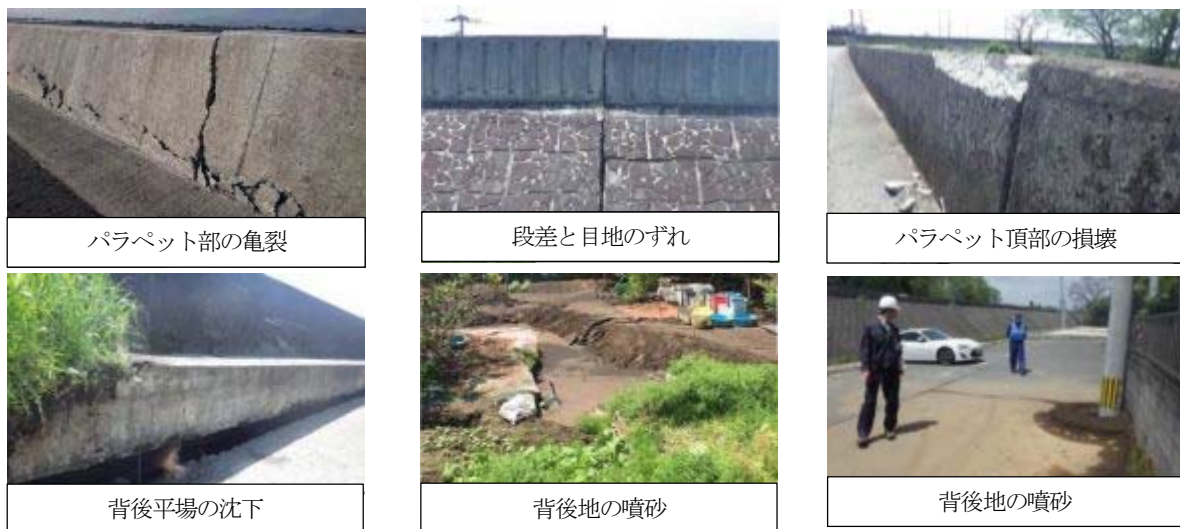
図-11 熊本地震における特殊堤の被災事例(左図:右岸0k020,中央図:右岸8k600~8k900,右図:左岸8k400~8k800)
