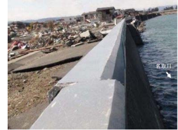
図-9 擁壁の被災事例(名取川) 18)
