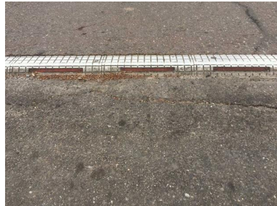
図 3.4 赤丸内の段差
