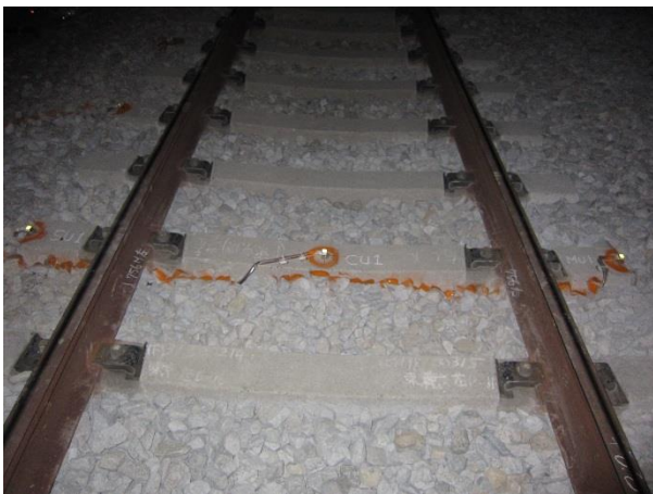
(c) 沈下箇所まくらぎ
