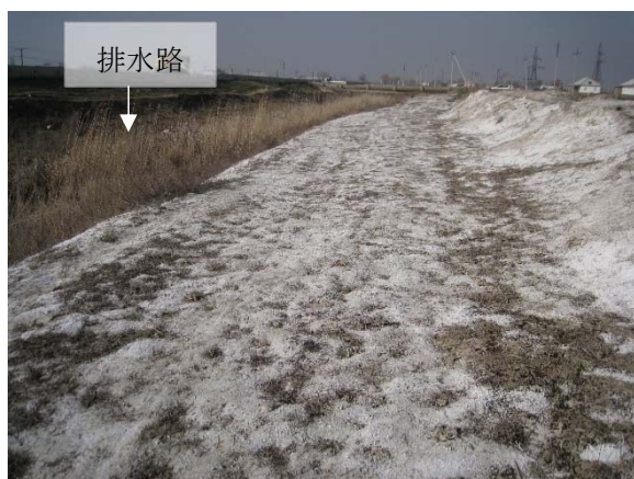
写真 2.3.1 排水路周辺に析出した塩類
