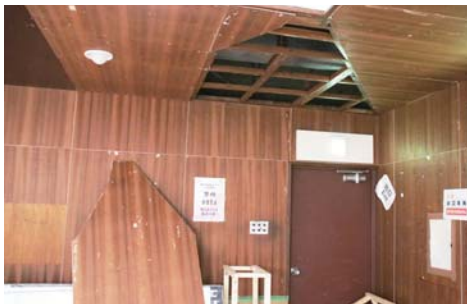
天井のはめ板が落下したとみられる追越共用棟の娯楽室 (5月8日、追越共用棟で) = 秋田耕平撮影
