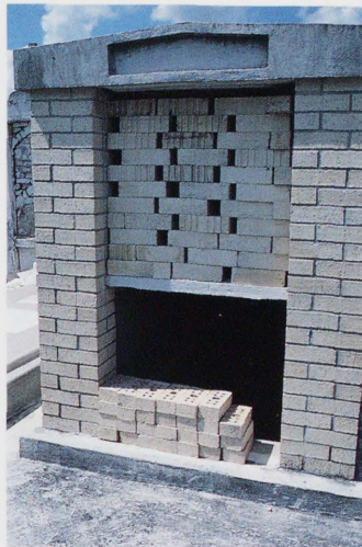
写真4 アセンション・カトリック墓地内にある建築中の2階建て地上埋葬墓 (1984年9月24日)
