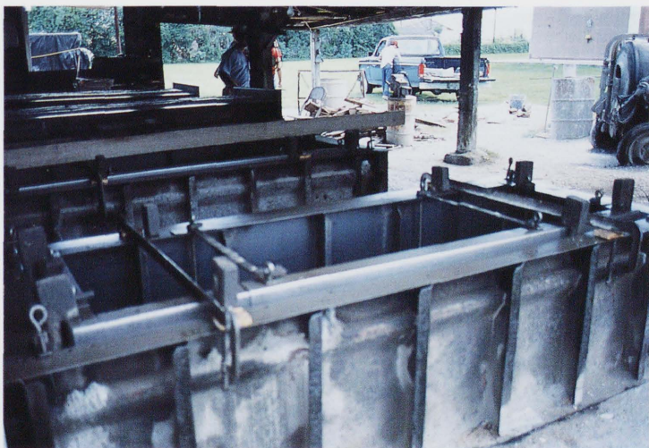
写真6 コンクリート棺製造所内 鑄型にコンクリートを流し込んで製造する。 (アセンション・カトリック墓地, 1984年9月24日)
