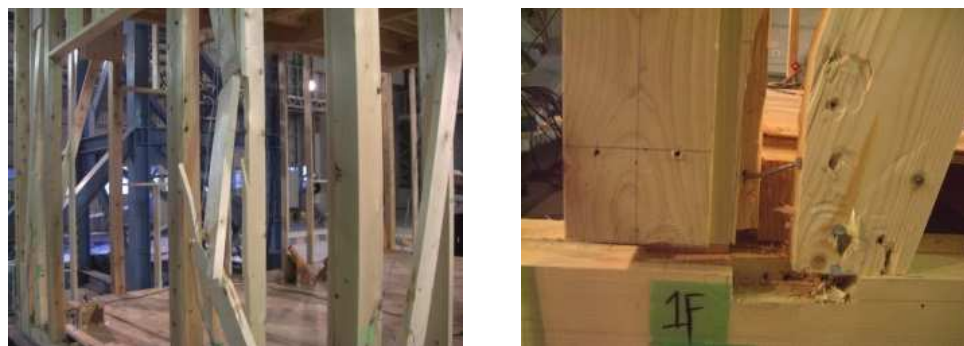
(a) 筋かいの座屈破壊 (b) 通し柱の浮き
