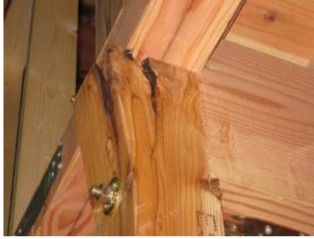
図 2.9 管柱の縦割れ（試験体②，JMA 輪島 100%後）
