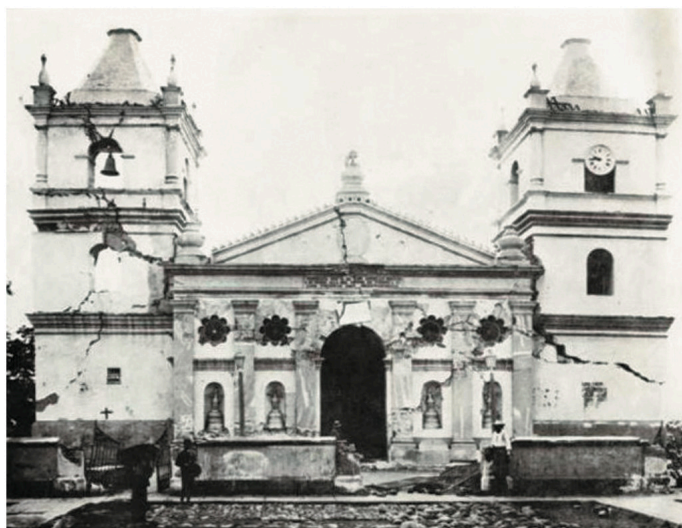
Figure 42: Basílica of Our Lady of the Angels destroyed by the Cartago earthquakes. Source: Sonia L. Gómez Vargas, La Basílica de Nuestra Señora de Los Ángeles: Testimonio Arquitectónico de la Fe Costarricense , (Ministerio de Cultura y Juventud, 2007), 24.
