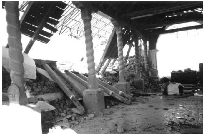
Figure 16: Santa María de Ostuma Church after the second earthquake of 2001, source: Teresa Guevara P. L., and A. Roberto Sánchez-Ramírez. “Los Sismos De Enero Y Febrero De 2001 En El Salvador Y Su Impacto En Las Iglesias Del Patrimonio Cultural.”
