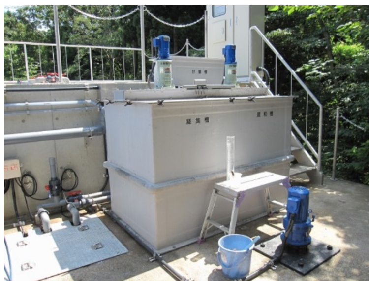
写真 2 - 4 計量槽及び凝集反応槽
