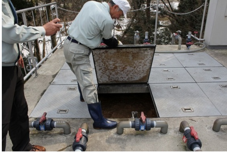
写真 2 - 5 曝気槽及び膜分離槽
