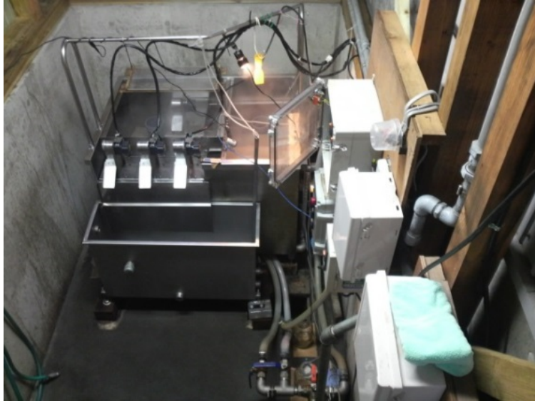
写真 2 - 2 油水分離装置の外観
