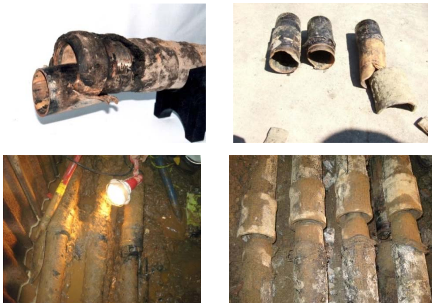
写真4.7 実際の地震による管路の被災状況
