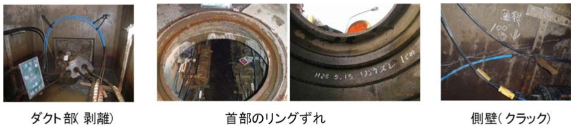
図 2.5 マンホールでの主な被災現象
