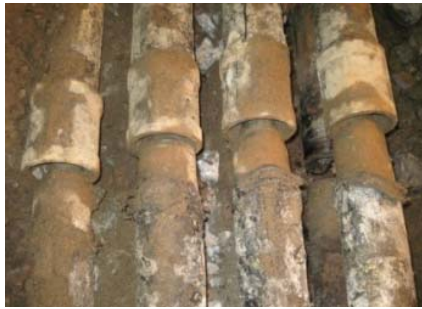
写真 4.1 地震による継手損傷
