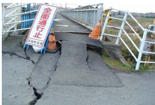
(a)橋台背面の沈下(正面)
