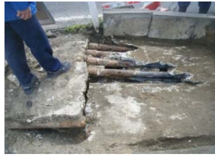
写真 4.2 地盤変状による被害
