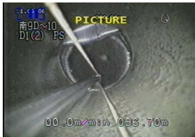
写真 2.8 地震動及び地盤変状による代表的な被災状況(管路の離脱)
