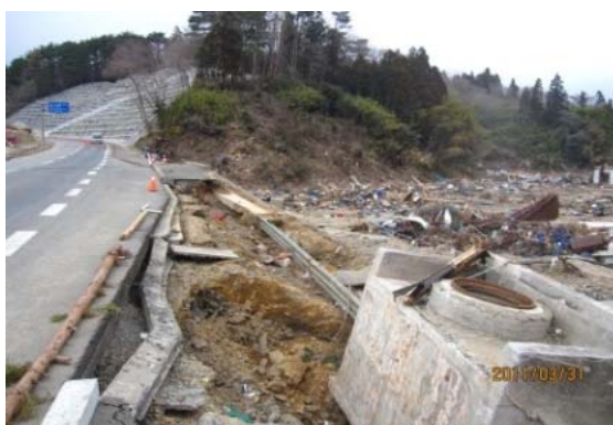
写真 2.6 津波による代表的な被災状況(洗掘された管路, マンホール)
