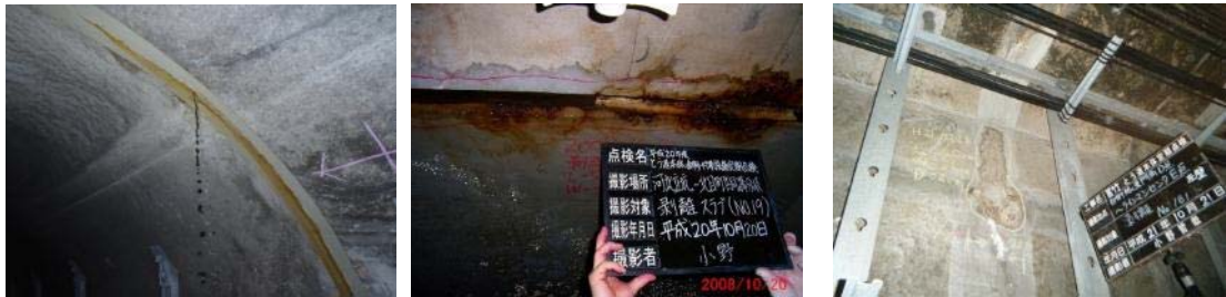
①継目(左:漏水 右:剥離)
