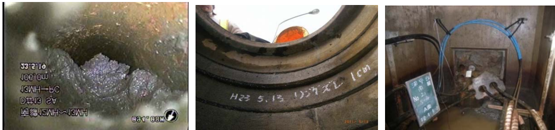
(a)管路内へ土砂流入 (b)マンホールの首部ずれ (c)マンホールのダクト部損傷
