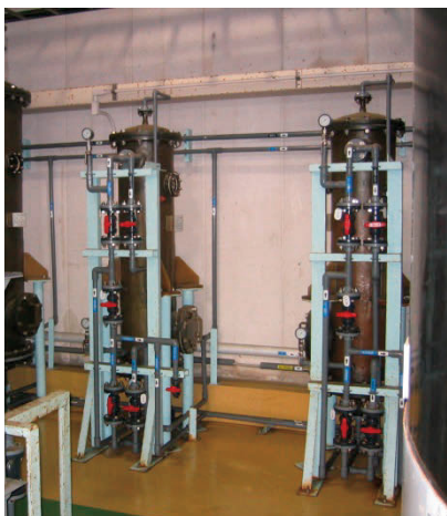
写真 1. 無機系廃液処理施設キレート樹脂塔
