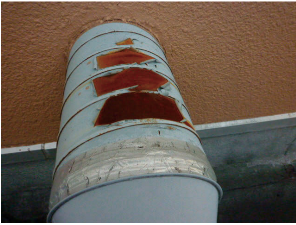
図 7. さびていたダクト
