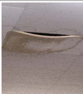
1C棟では、雨漏りが原因で天井がはがれかけていた(7月1日、1C棟)
