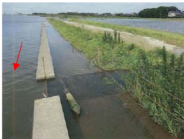
図-2.13(3) 矢板の被災事例（利根川下流太田地先）
