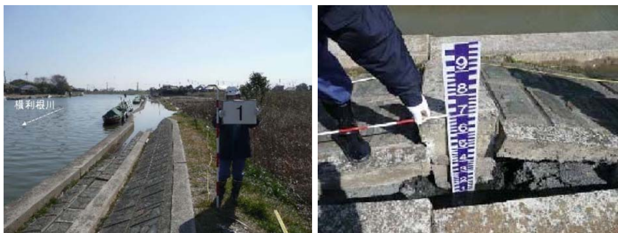
図-2.13(4) 矢板の被災事例（横利根川香取市）
