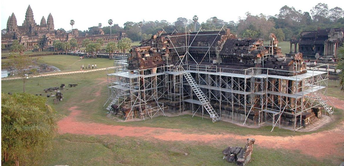
写真1 アンコール・ワット北経蔵の修復工事（日本国政府アンコール遺跡救済チーム）
