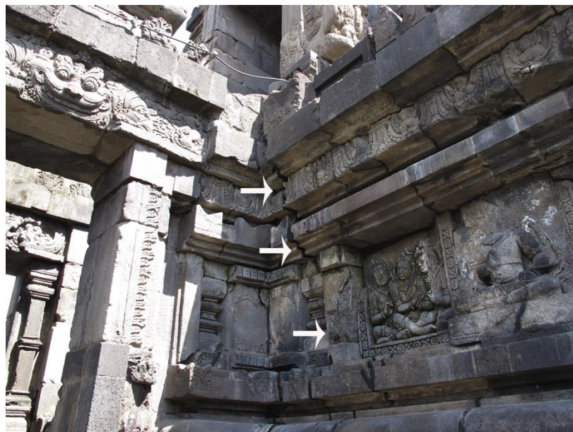
図 6 シヴァ祠堂身舎部に生じた亀裂
