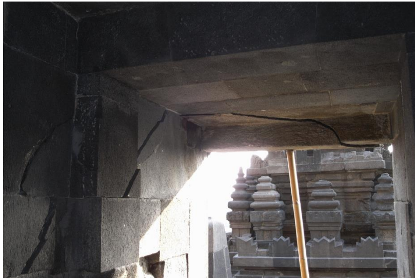
図 7 シヴァ祠堂西側房入口に生じた亀裂
