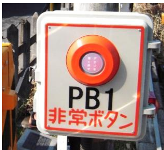
図 6 踏切支障報知装置（操作器）の例
