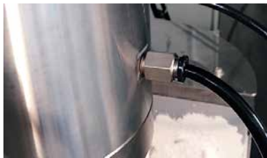
図11 冷却水ホースの接続部 (※2部分) (接続部は折れやすく、何度も修理依頼)
