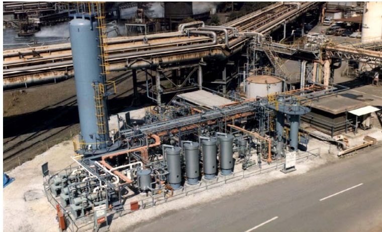
図 2.1 神戸製鋼所 CO-PSA 1 号機 (1989 年建設)
