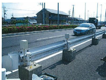
路側設置型の観測機器の例 25)
