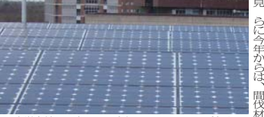
大学会館の屋上に設置されているソーラーパネル
