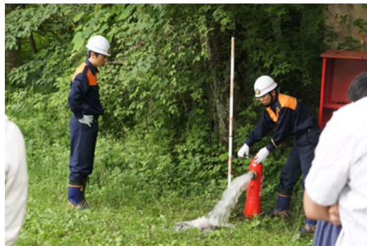
図 1. 消火栓と器具箱(右の赤い箱)
