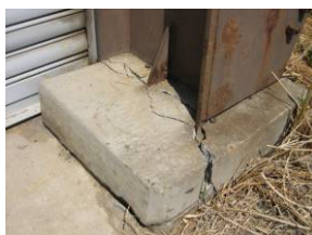
図 24. 割れたコンクリート塊
