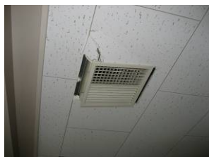
図 10. 6 階廊下天井ダクト 周辺の破損
