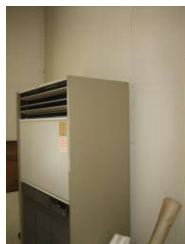
図 21. 壁から外れた空調機
