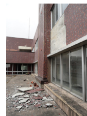
図 2. 外壁タイルの脱落
