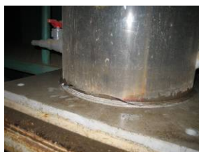
図 23. 割れた沈降管
