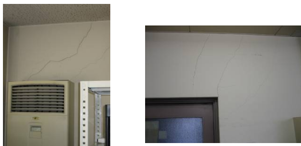
図 18.2 階データ収録室・研究室の壁の亀裂
