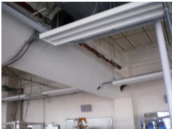
図5. 梁の脱落 画面左側のケーブルに引っ掛かっている。後日、撤去した。
