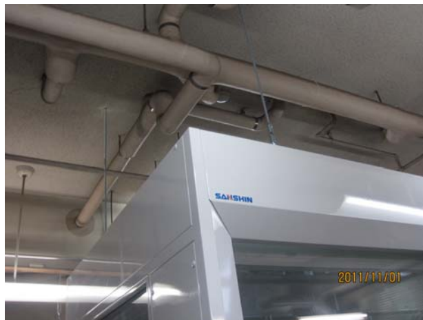
図3b. 局所排気装置を天井から吊り下げた様子
