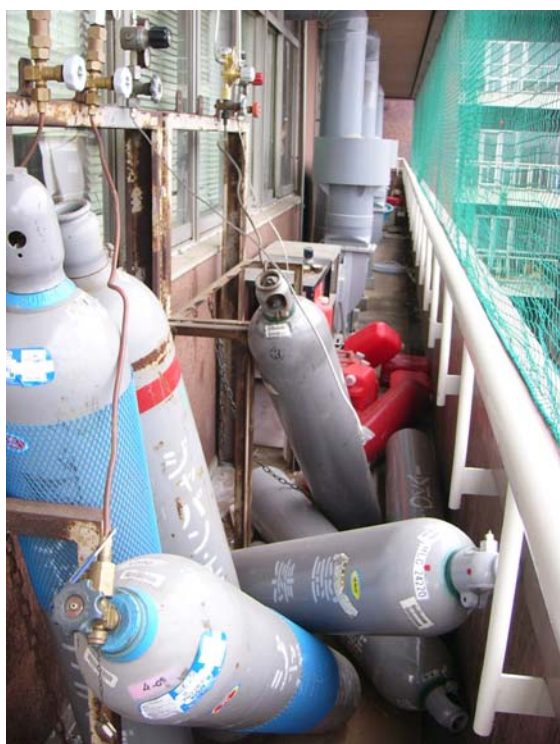
図2. 自然系学系棟C棟5階高圧ガスボンベ置き場
