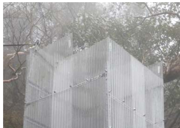
図 13. 図 2 の OTC の修復後
