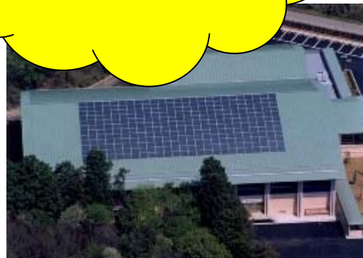
筑波西中学校体育館 50kW
