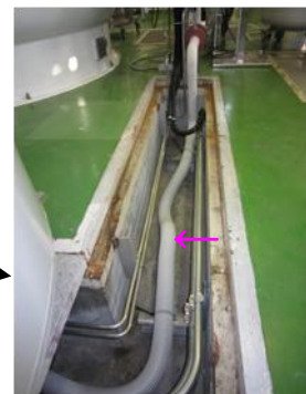
図5. フレキシブル回収配管
