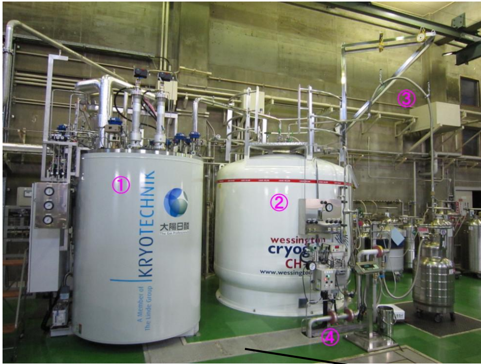
図2. ヘリウム液化機・液体ヘリウム貯槽
