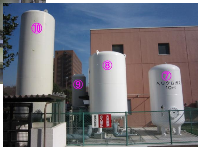
図4. バッファータンク・液体窒素貯槽
