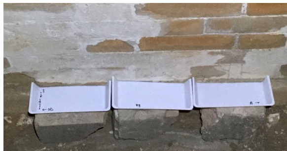
図 3.7 崩落物測定の様子 (著者撮影)
