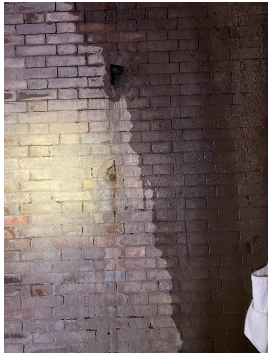
図 3.13 隧道に見られる漏水の様子
