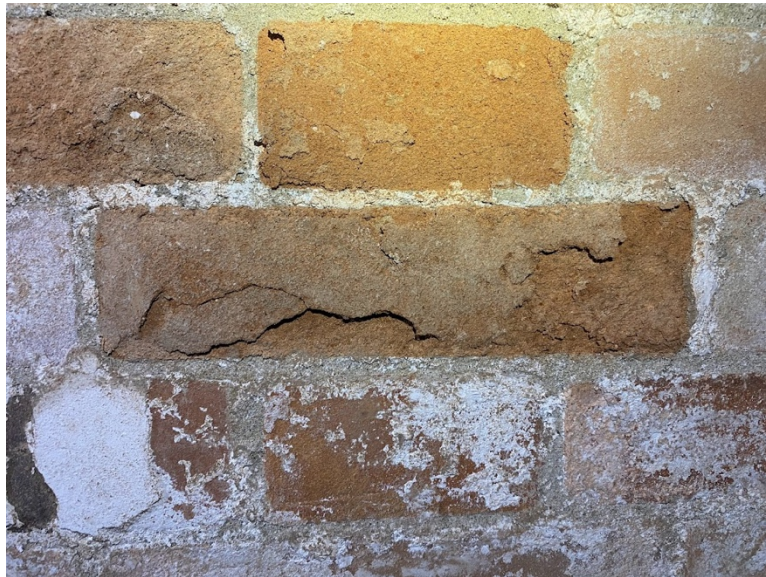
図 1.2 劣化した煉瓦表面 (著者撮影)
