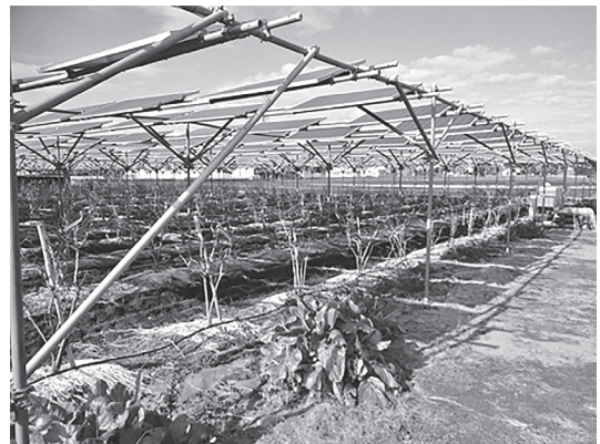
図4 ソーラーシェアリング架台
