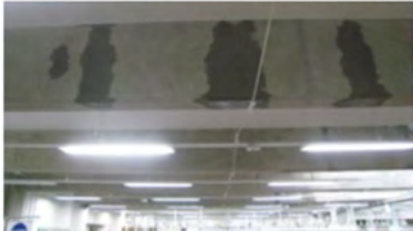
天井からの漏水
