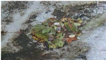
詰まった排水口
