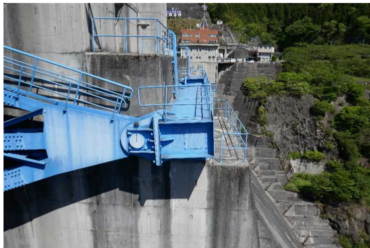
(c) アンカーレッキ (トラニオンゲーター部) の状況
