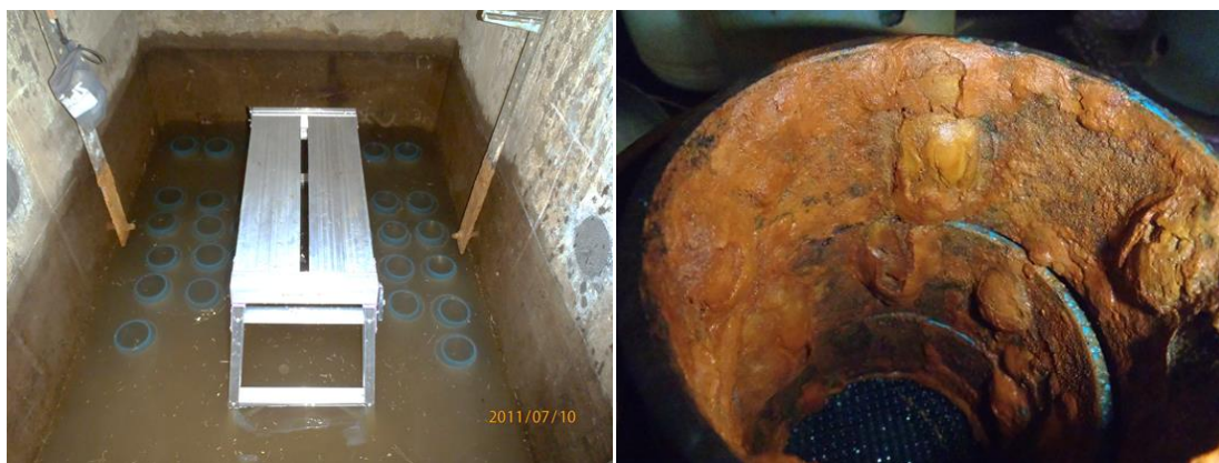
図 2-9. 腐食実験における供試体のマンホール内設置状況及び供試体の腐食状況 5)
