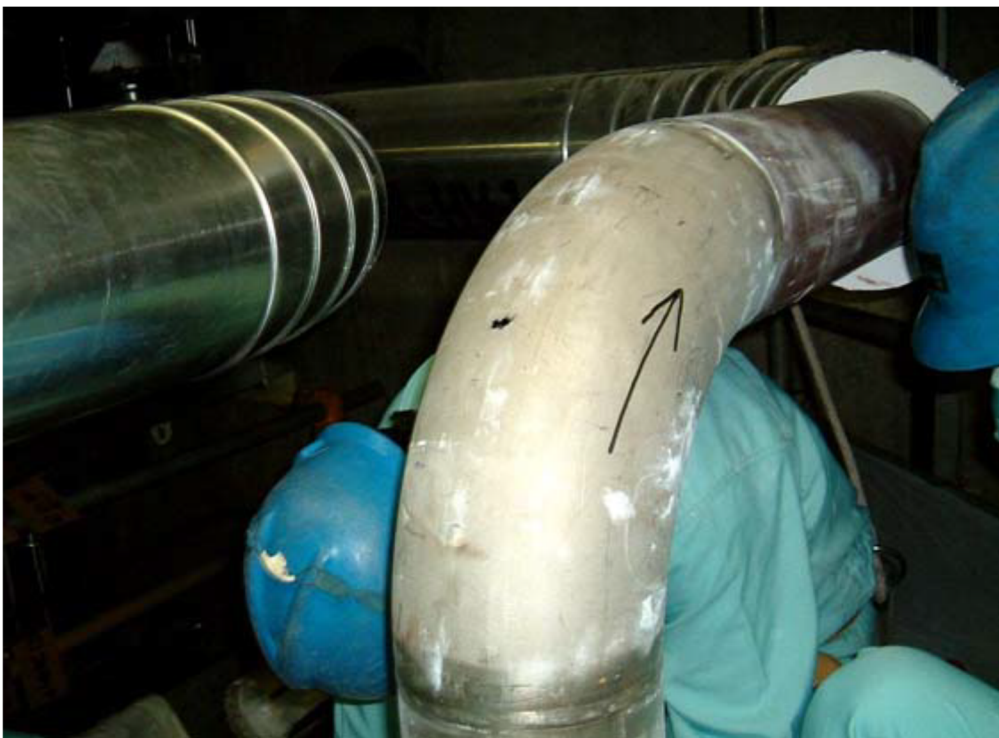
(b) 液滴衝撃エロージョンに起因する減肉による配管破損 [8]
