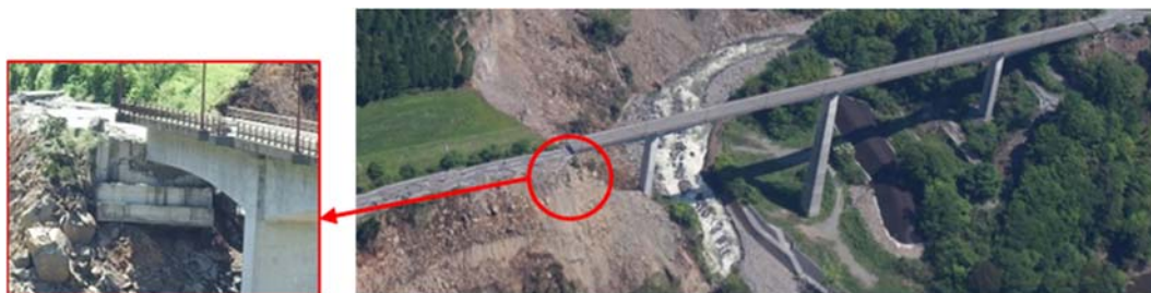
写真-1.2 斜面崩落により機能喪失した橋(阿蘇長陽大橋) 21)
