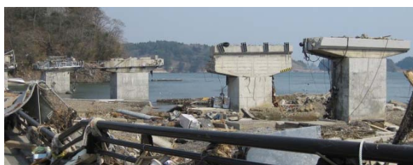
(a) 上部構造が流出して機能喪失した橋
