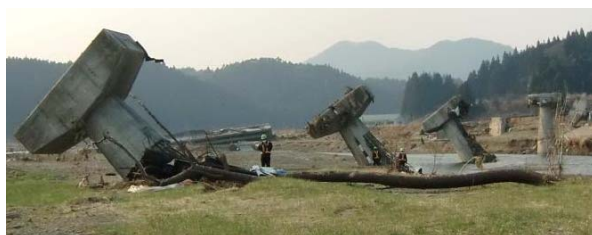
(b) 下部構造の倒壊も伴って機能喪失した橋
