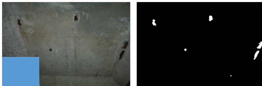
(b) 劣化ランク 2 の露筋
