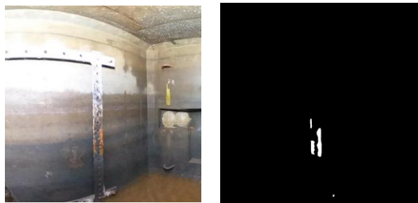
(a) 劣化ランク 1 の金物腐
