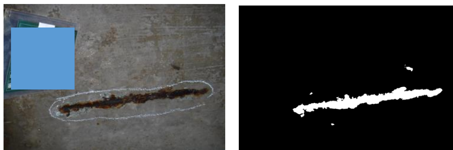
(c) 劣化ランク 3 の露筋
