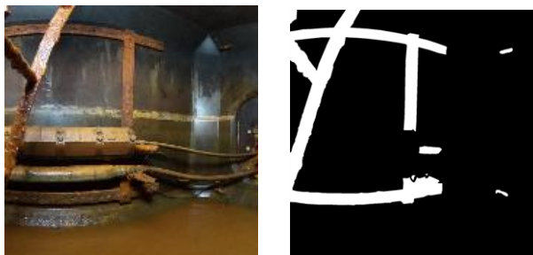
(d) 劣化ランク 4 の金物腐
