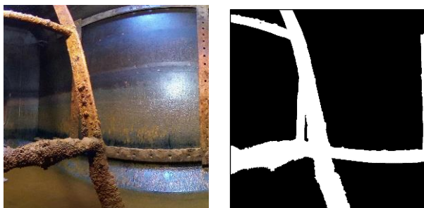
(c) 劣化ランク 3 の金物腐
