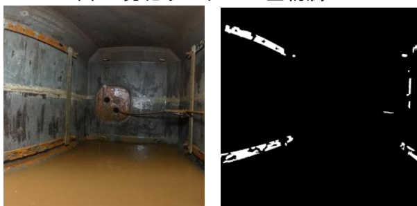
(b) 劣化ランク 2 の金物腐
