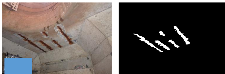
(d) 劣化ランク 4 の露筋
