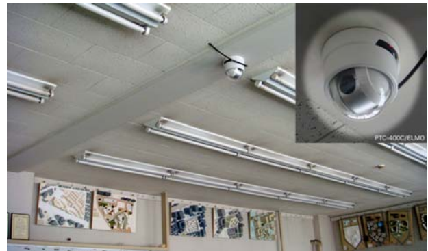
図6. 設置されたカメラと設置状況
