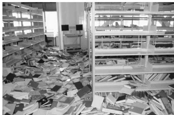
写真2 通路使用不可能(中央図書館本館4階)
